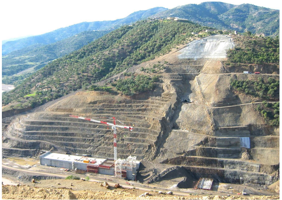
Los movimientos y desprendimientos amenazan la estabilidad de la obra así como a los equipos de obreros
