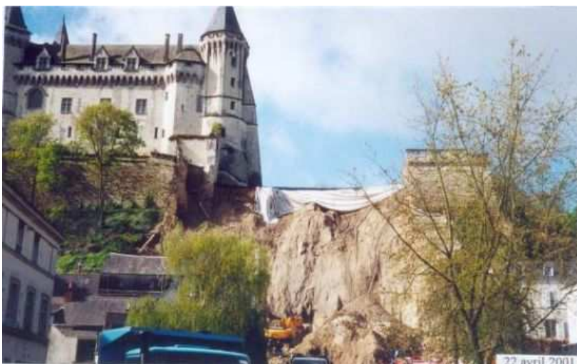
Effondrement du rempart nord suite à l'éboulement de son terrain de support
